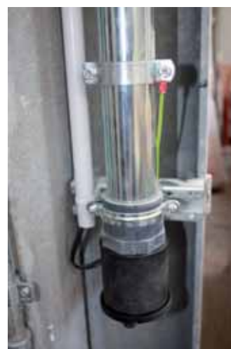
Presa aspirante antistatica con collegamento di terra.
